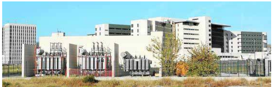
El tercer transformador de electricidad (dcha.) se ha instalado en septiembre. ■ RAMÓN L. PÉREZ
