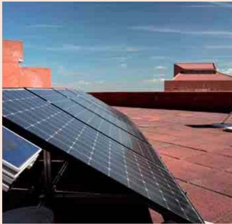
Paneles solares colocados en una de las terrazas de la UAM.
