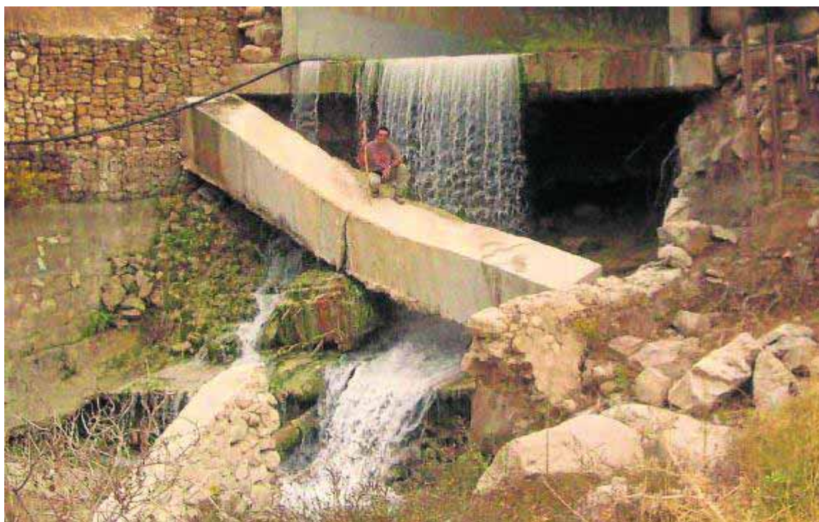
Vertidos causados por un acuífero perforado en el valle de Abdalajís en las obras del AVE. :: SUR
