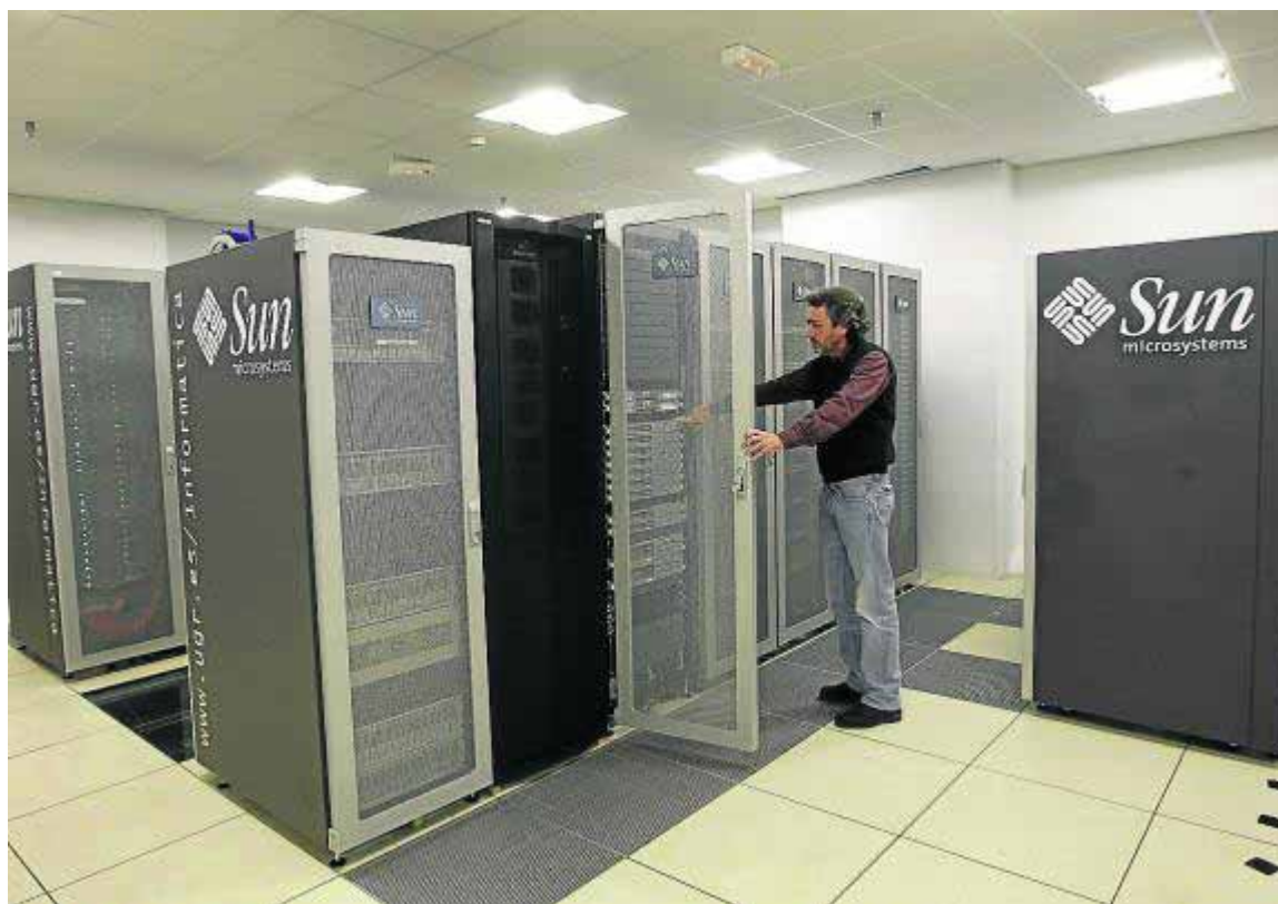
Instalaciones de supercomputación en el edificio Mecenas. ■ G. MOLERO
