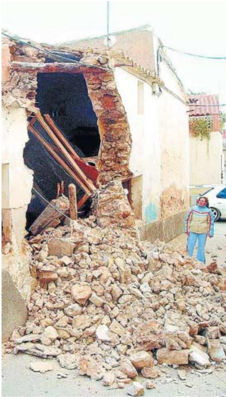
Un edificio medio en ruinas tras el terremoto de Lorca.
