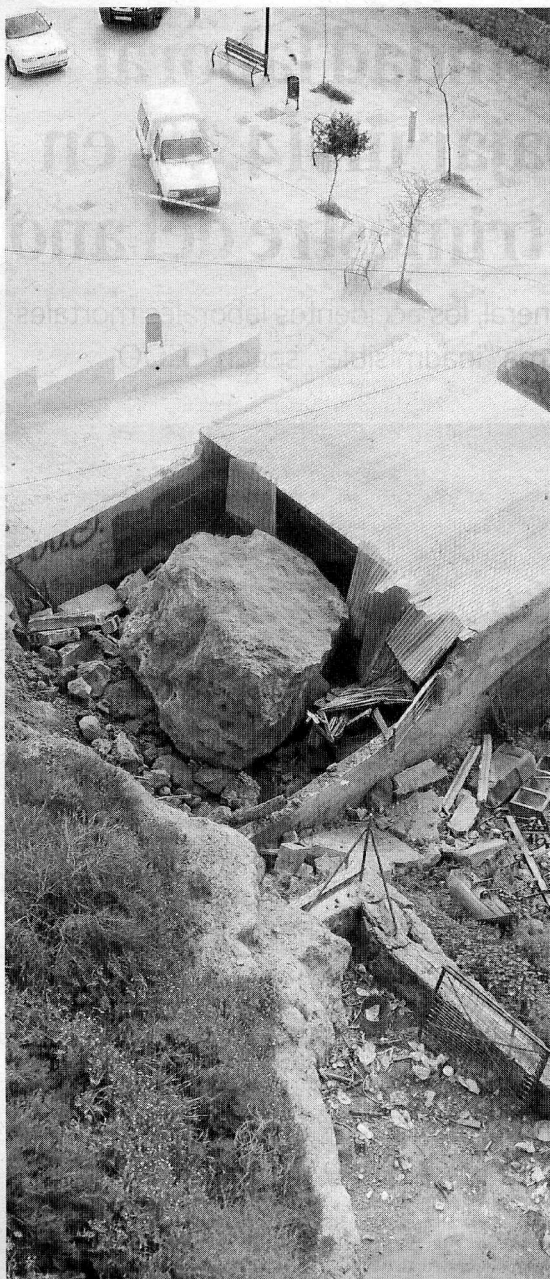
Estado en el que quedó uno de los garajes afectados.
