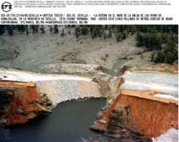
La rotura en el muro de la balsa de la mina que produjo el desastre de Aznalcóllar. :: EFE
