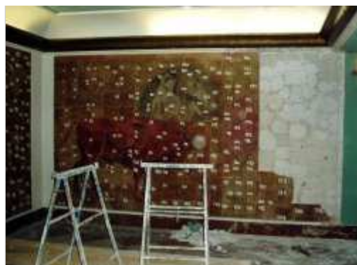
La retirada de las piezas no se realizó de manera correcta. / ENRIQUE
