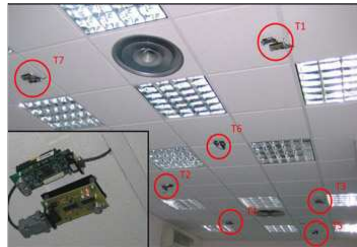
Sistema de sensores dispuesto en el techo de la sala
