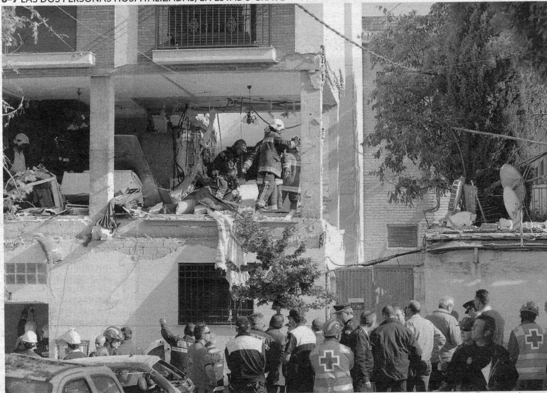
Los bomberos retiran los escombros de los apartamentos afectados por la deflagración.
