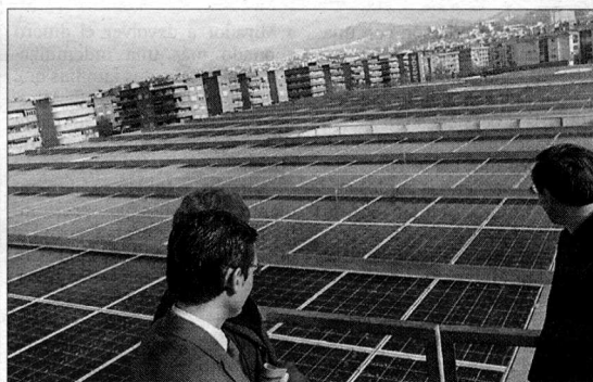
Instalación de energía solar en el Parque de las Ciencias. / EFE
