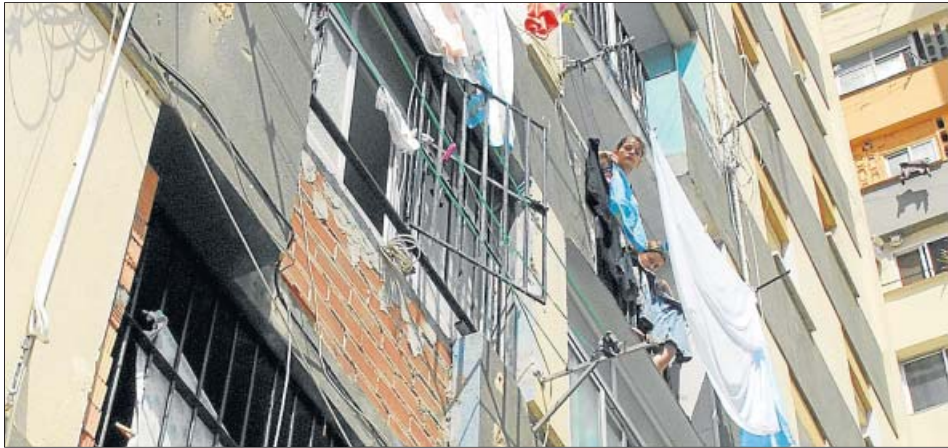
Fachada de un edificio de la calle Cabriel, en el barrio malagueño de La Palmilla.
