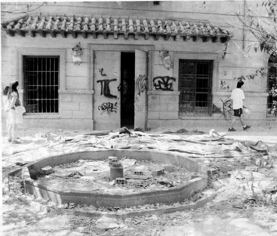
DETERIORADO. Imagen del palacete y el exterior. /IDEAL
